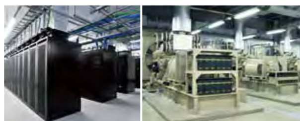
▲サーバールーム
